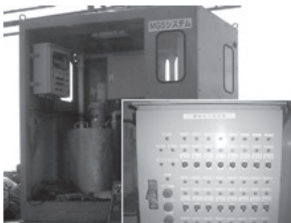
写真-6 MG剤注入制御盤
