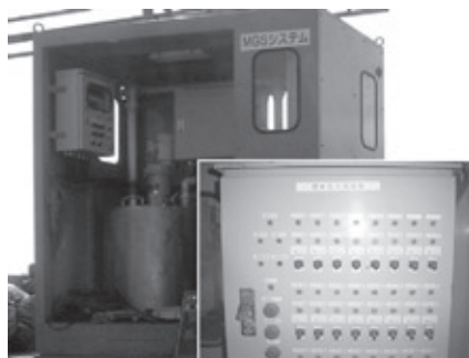
写真-6 MG剤注入制御盤
